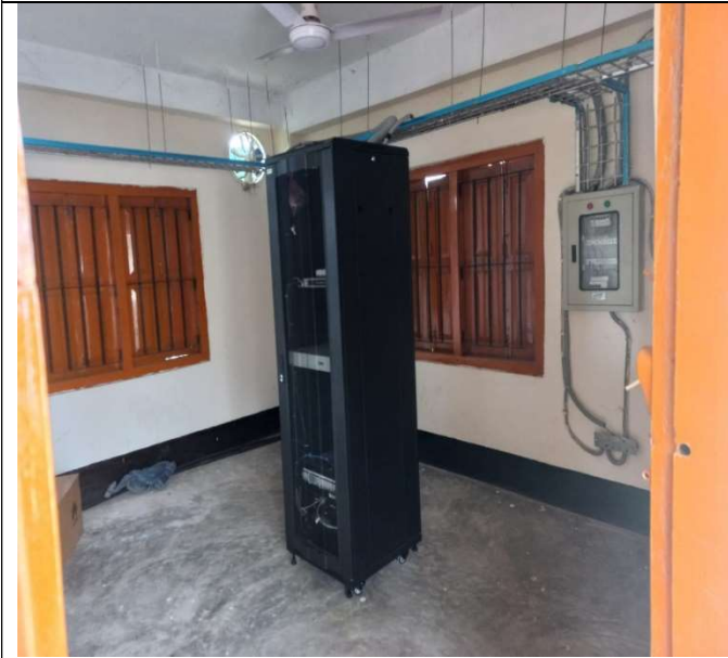
প্রকল্পের PoP রুমে Active Equipment স্থাপন করা হয়েছে।
